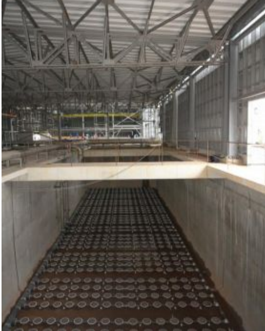
Fotos da Estação de Tratamento de Esgoto SABESP (2017)
