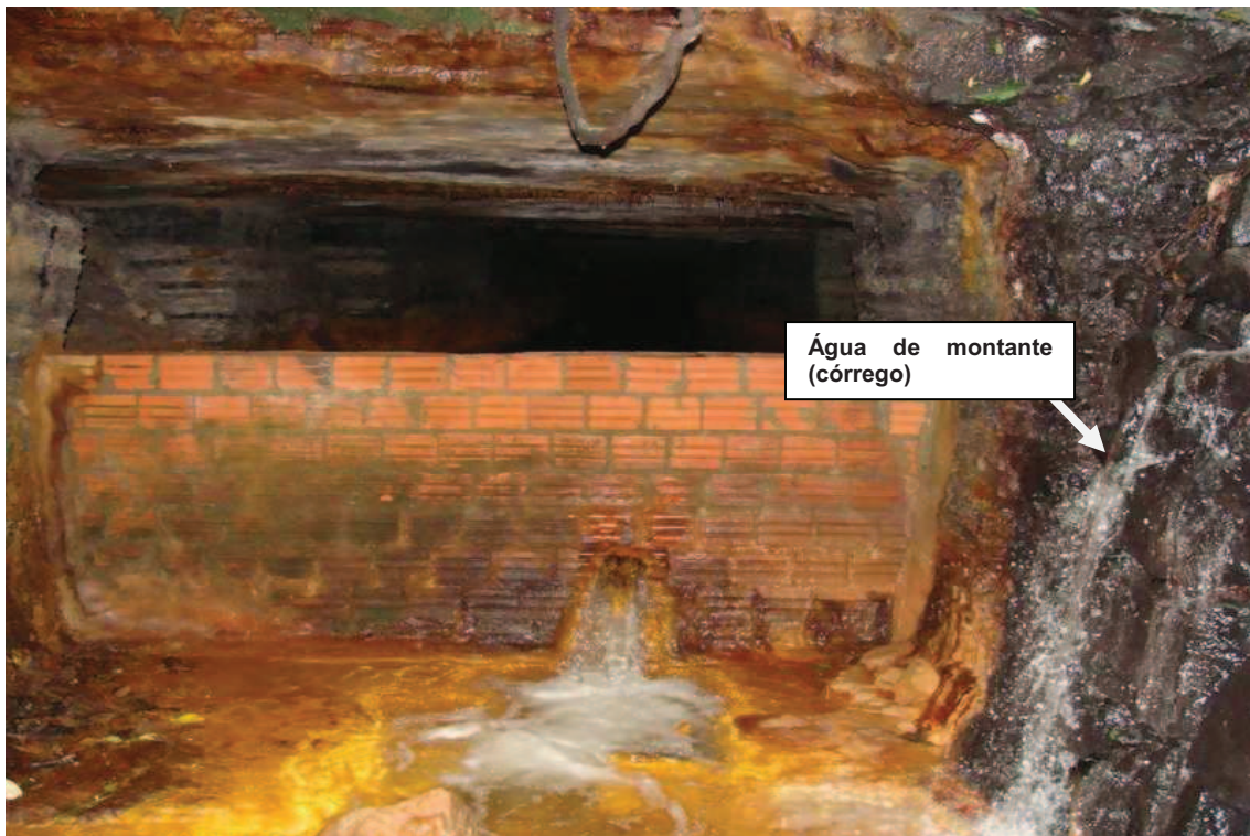
Figura 23: BM 01 com detalhe da água do córrego que escorre para a frente da galeria. (Fonte: CANCELIER, 2009)
