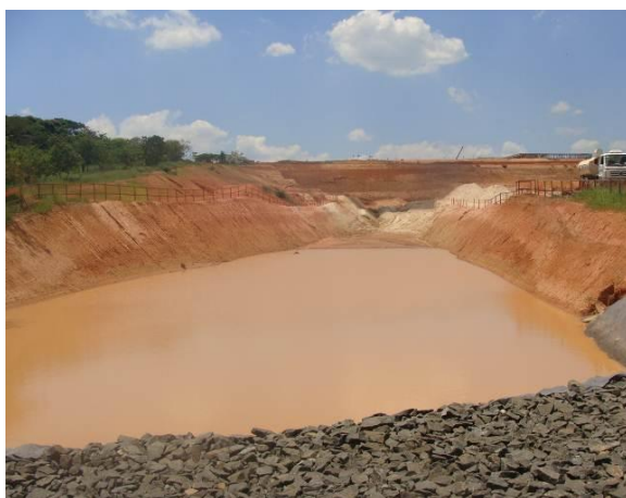
Figura 15 - Bacia de contenção de sedimentos em obras aeroportuárias
