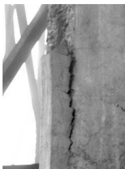
Figura 5.3 - Spalling em pilar de concreto
