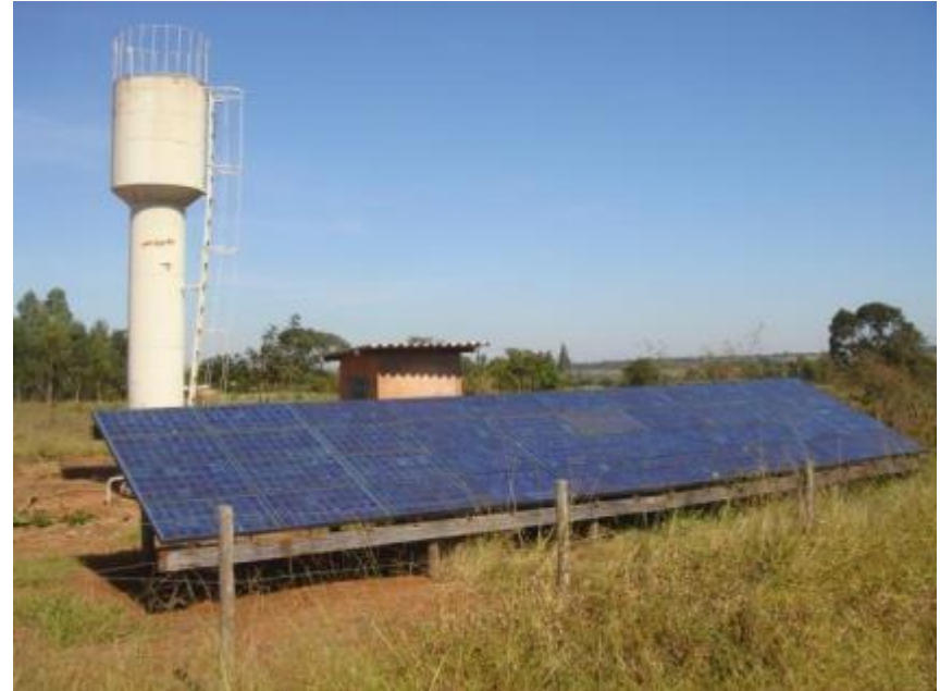
Bombeamento, Projeto LSF-IEE, ITESP, Presidente Bernardes, SP Bomba e condicionamento de potência de fabricação nacional
