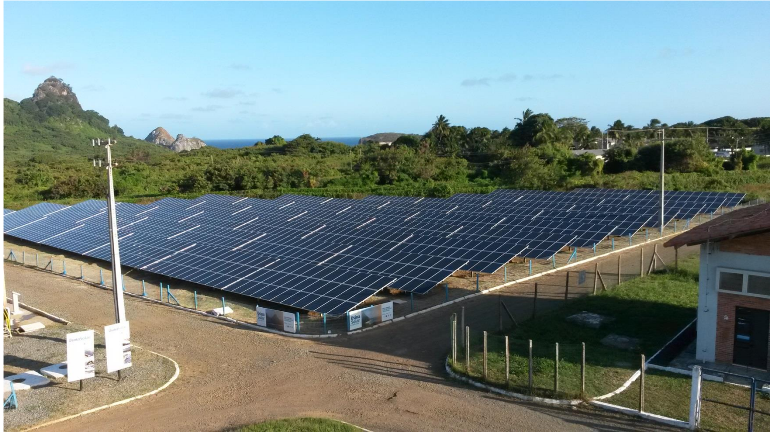
Usina FV Fernando de Noronha I, 400 kWp (CELPE)
