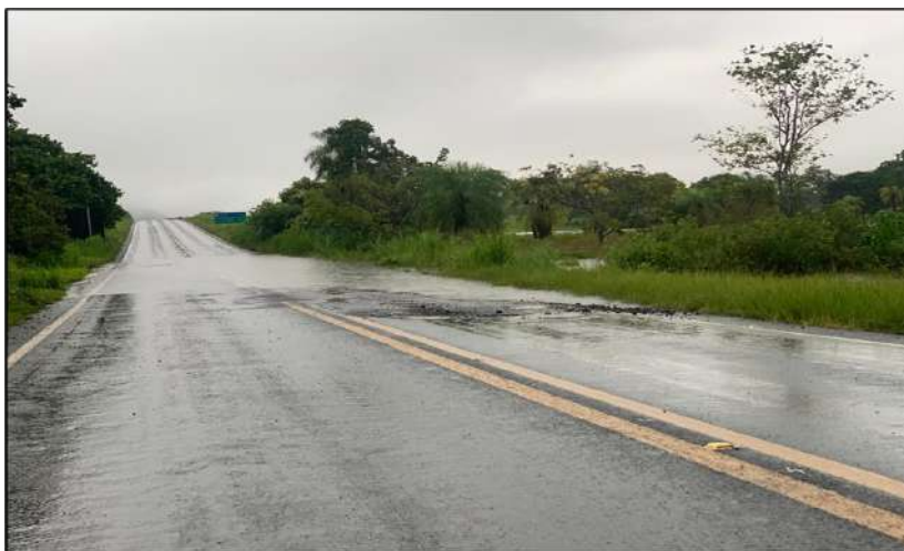
Figura 9. Estado de la carretera BR-267 que da acceso a la ciudad de Porto Murtinho/MS
