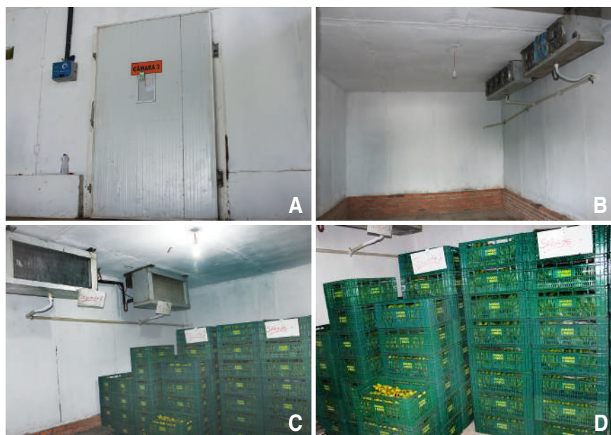
Figura 55. A) Vista externa da câmara de climatização; B) Vista interna da câmara de climatização; C e D) Bananas em climatização
