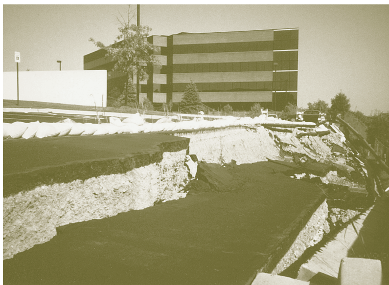
Figura 1.7 Um conhecimento mais detalhado acerca dos solos em que esta estrada foi construída poderia permitir aos engenheiros a elaboração de um projeto que redundasse em uma obra mais estável, evitando, assim, essa situação não apenas dispendiosa, mas principalmente perigosa. (Foto: cortesia de R. Weil)
