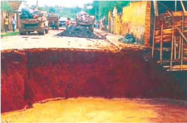
Figura 3.3.24 - Colapso do terreno na cidade de Sete Lagoas - MG em 1988.
