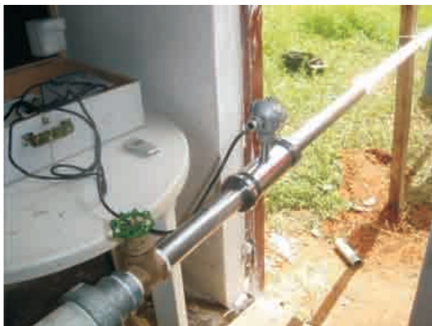
Figura 6.3.14 - Medidor de vazão tipo turbina instalado para teste de produção, realizado pelo DNPM-CE, em poço de água mineral, Barbalha – CE (Foto: Liano Veríssimo).
