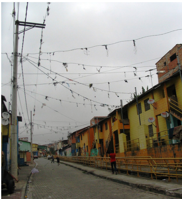
REDE ELÉTRICA: "GATOS"
