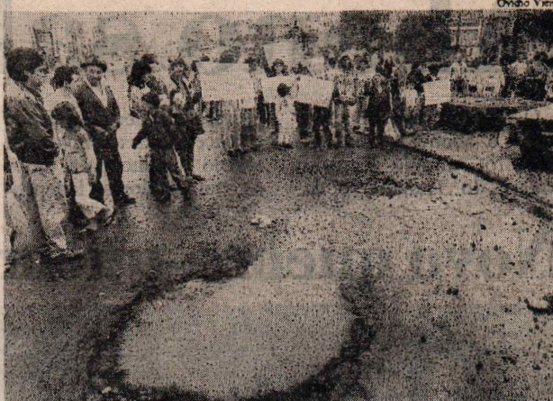
Moradores do Jardim Macedônia reclamam dos esgotos entupidos
