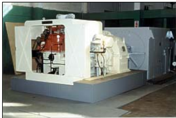
Figura 11 - Gerador de energia elétrica
