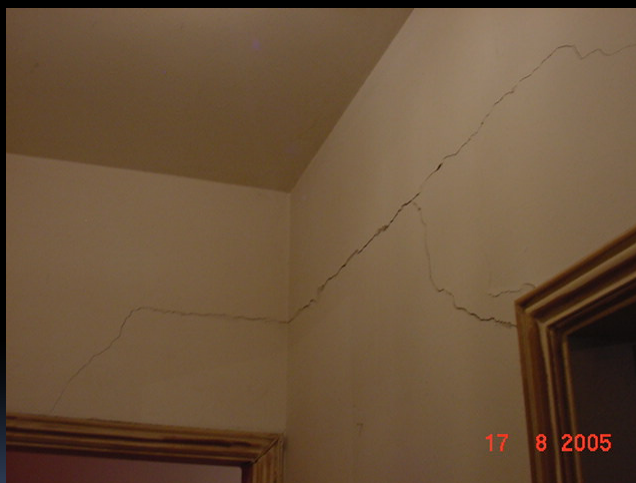
Conjunto de trincas em alvenaria e possivelmente estrutura => necessidade de melhor investigação. Abertura de trincas significativa
