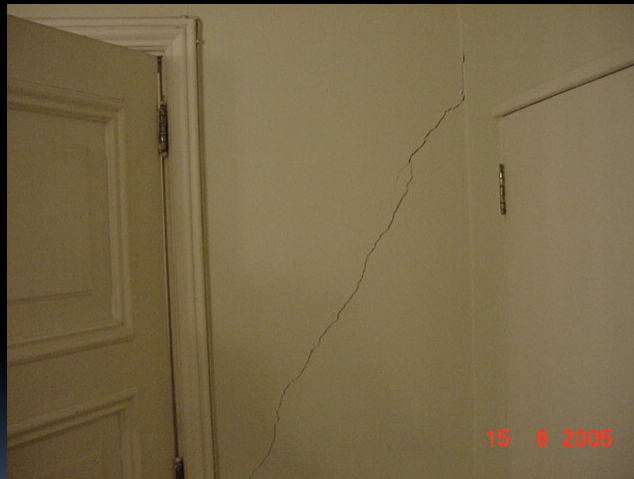
Trinca inclinada em alvenaria – recalque diferencial => aparentemente sem dano estrutural
