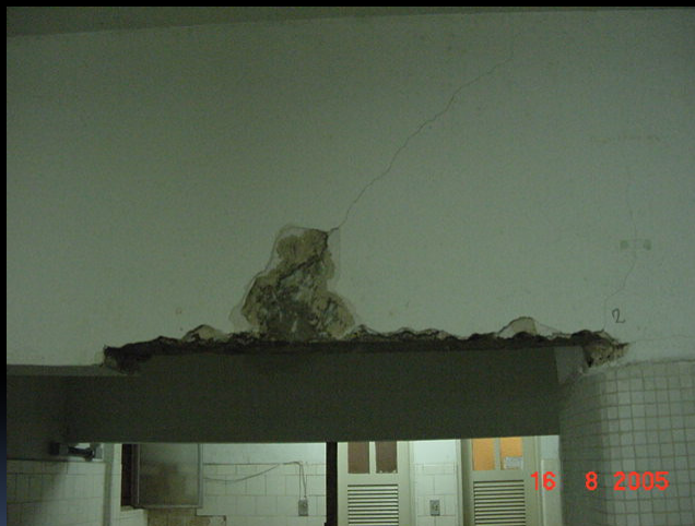
Trinca inclinada em viga => foi removido revestimento e confirmado dano na estrutura => CRÍTICO!
