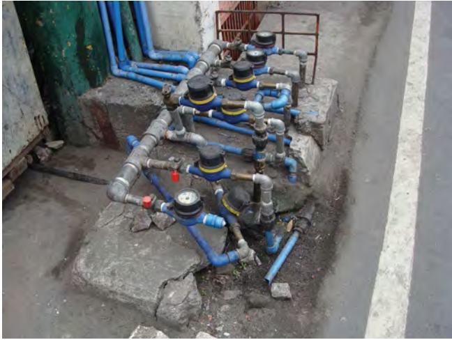
Manila, Filipinas Tubos e medidores de válvulas de gás expostos.
