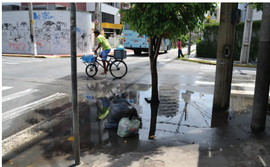
Fortaleza, Brasil. Formação de poça d'água devido à falta de drenagem ou de infraestrutura verde.
