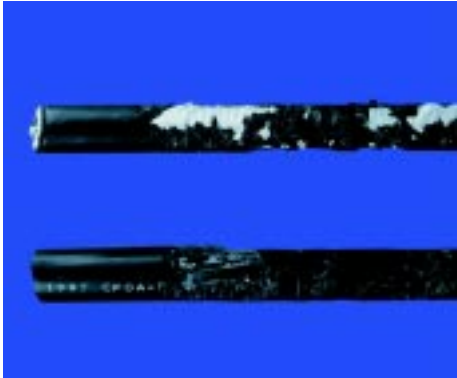
Teste realizado em campo mostrando o cabo atacado por roedores.
