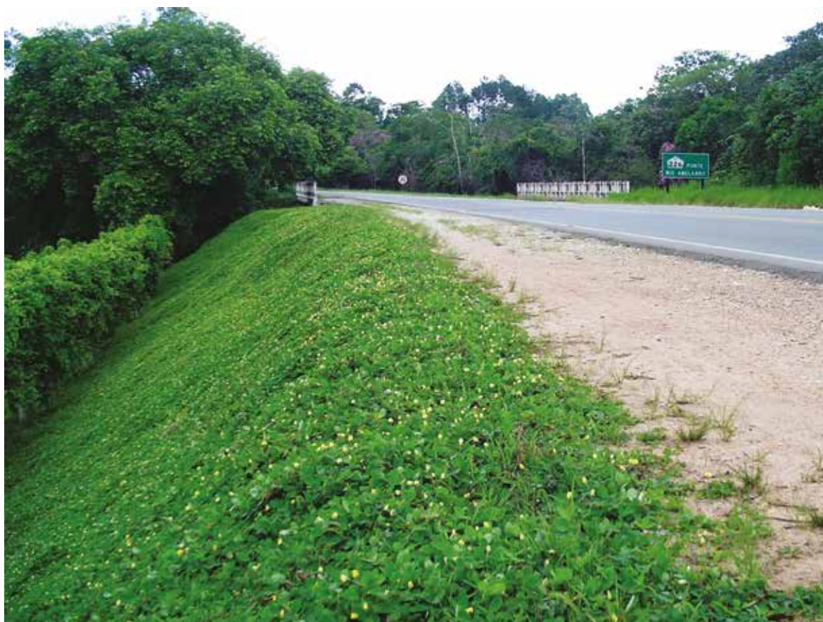
FIGURA 3. Arachis pintoii utilizado para conter erosão em talude. Foto: José F. M. Valls.
