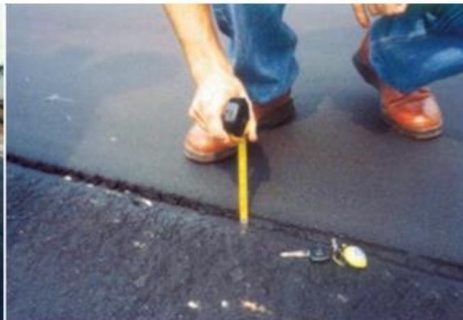
(b) detalhe da espessura delgada do revestimento
