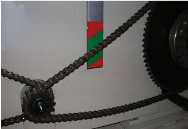
Para inspeção da tensão de acionamento
