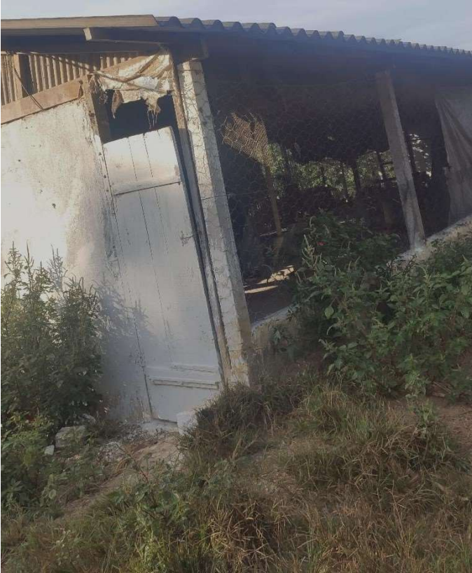
Foto 1- Galpão com aves alojadas em condições precárias.
