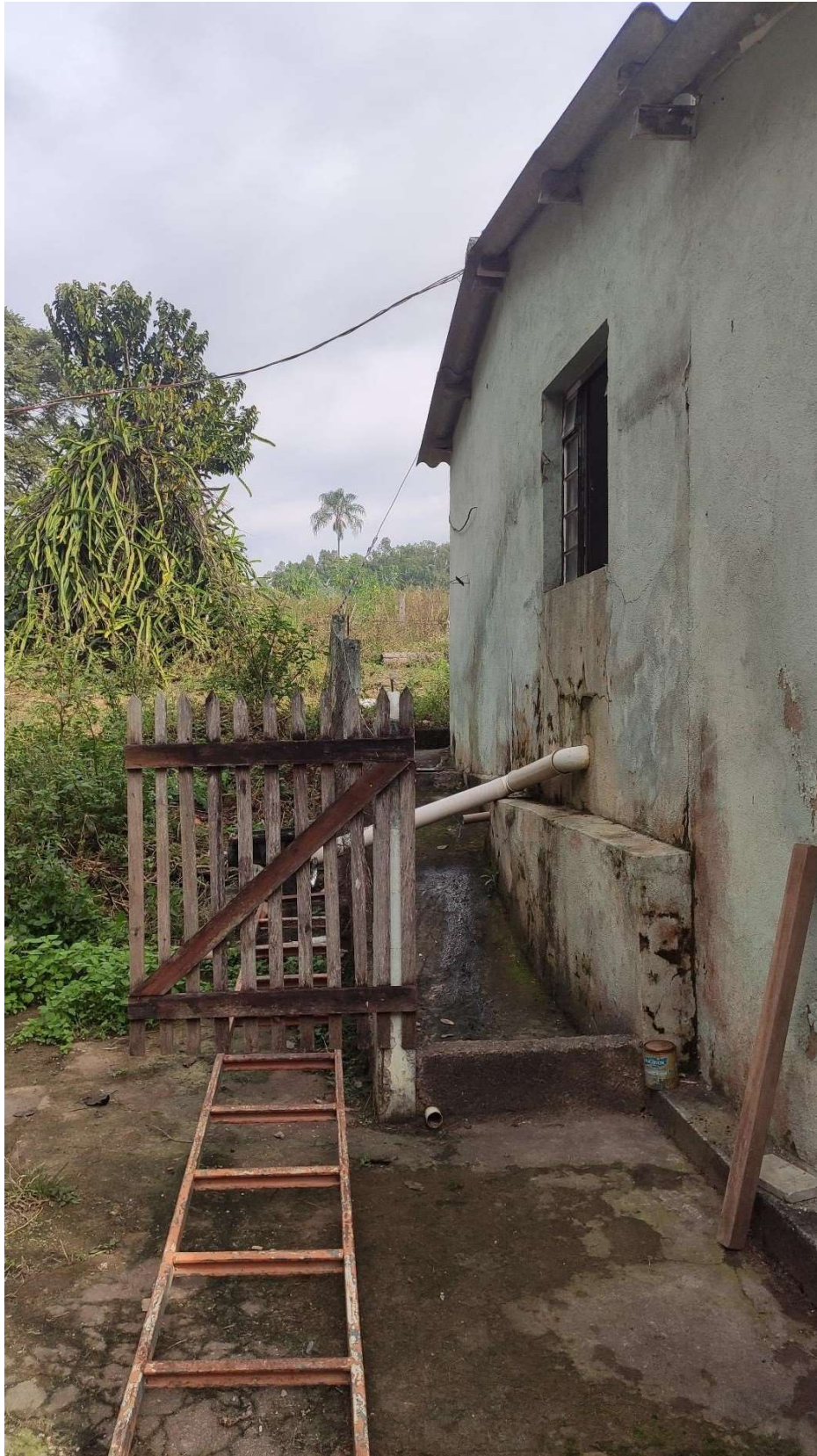
Foto 31 – área externa do local onde as aves eram abatidas, com efluentes a céu aberto, sem delimitação de área.
