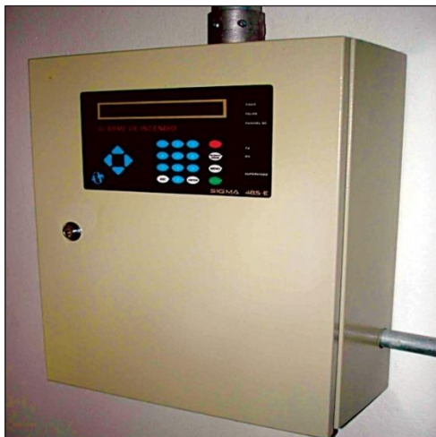
Figura 50: Central de alarme de incêndio
