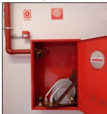
Figura 55: Detalhe de hidrante.
