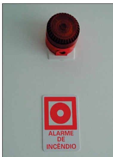
Figura 49: Detalhe de sirene.
