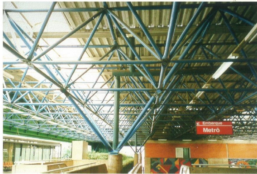
Cobertura da Estação Terminal Barra Funda do Metrô (fotografia de André Hiroshi de Oliveira Nishina)
