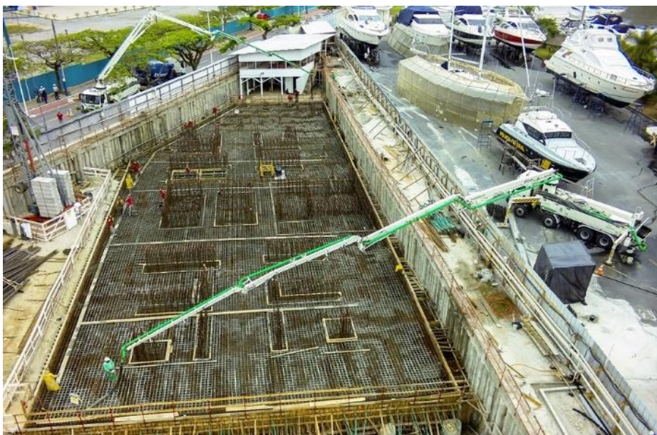
Edifício Yachthouse/SC, bloco de 4.600 m 3 (1300 m 2 x 3,5m) [81 andares e 275 metros de altura]
