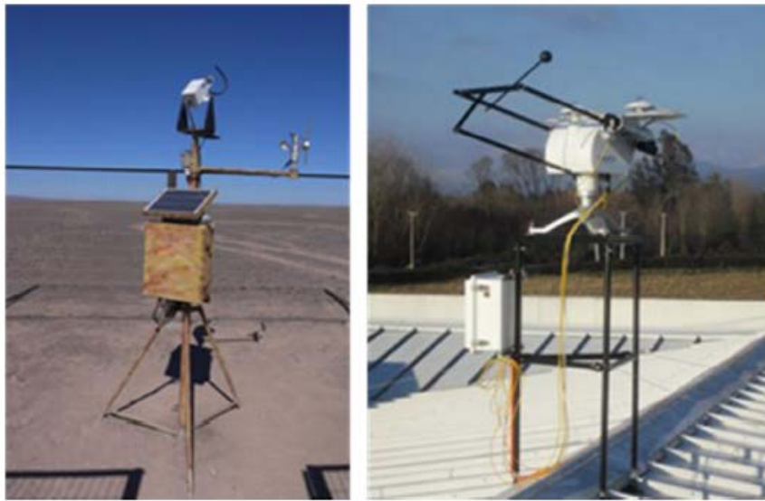
Figura 6. Estación RSBR en Crucero y una estación con seguidor, pirheliómetro, y piranómetro en Talca
