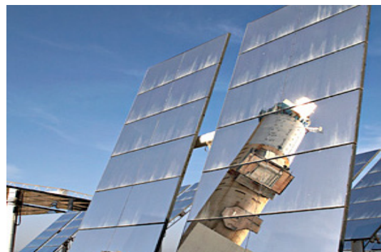
(c) Torre solar CESA-1
