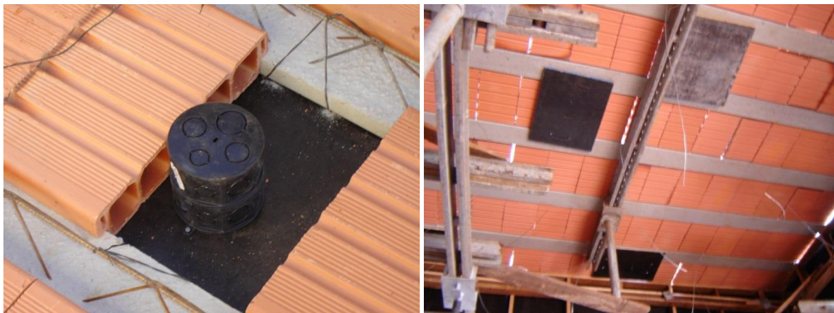
Figura 2 Esquerda: caixa de teto posicionada na laje de forro antes da concretagem, sobre fundo de madeira compensado (placa preta). Direita: destaque para a placa de fundo de madeira compensada vista na face inferior da laje de forro. Após a concretagem, a retirada da placa dá acesso ao interior da caixa para a passagem dos condutores (fiação). Fonte: acervo da disciplina AUT0190.
