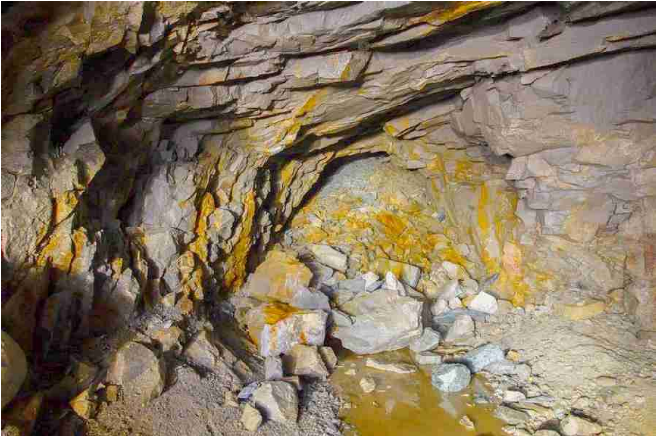
Queda de Blocos em Túnel
