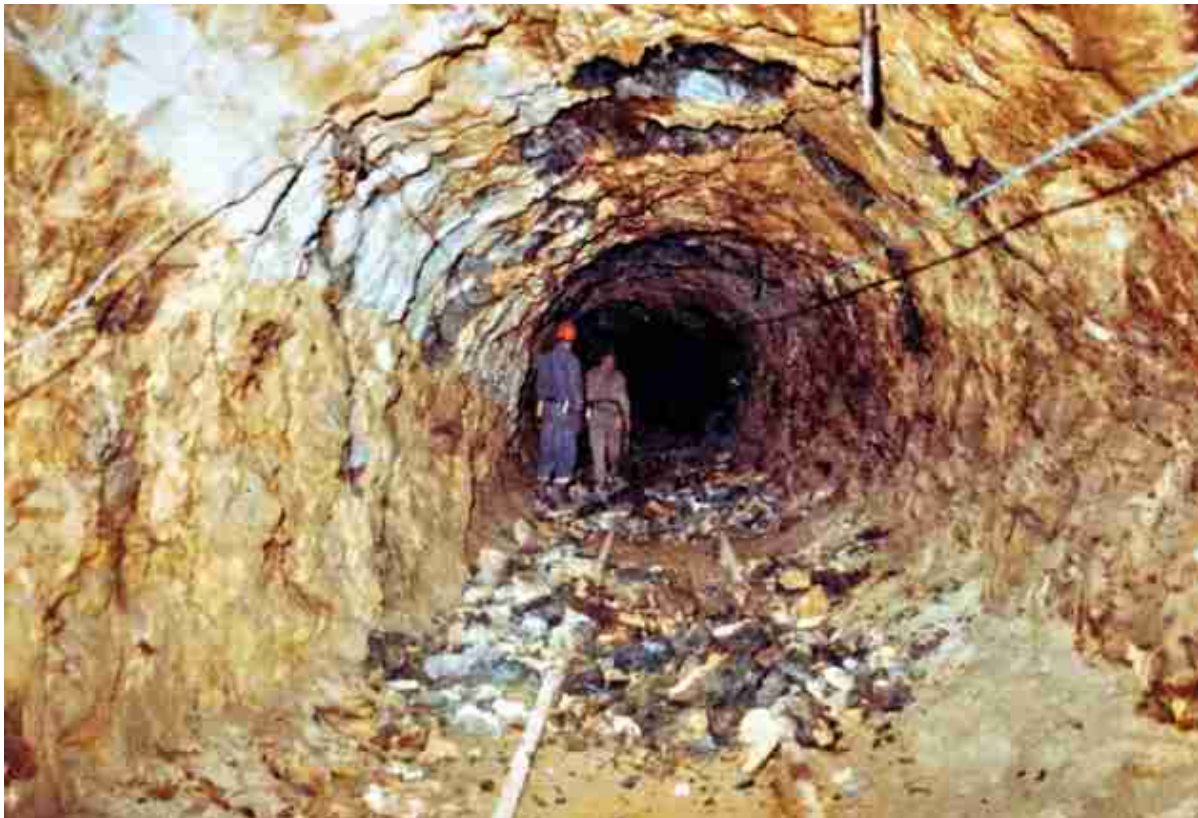
Queda de Blocos em Túnel
