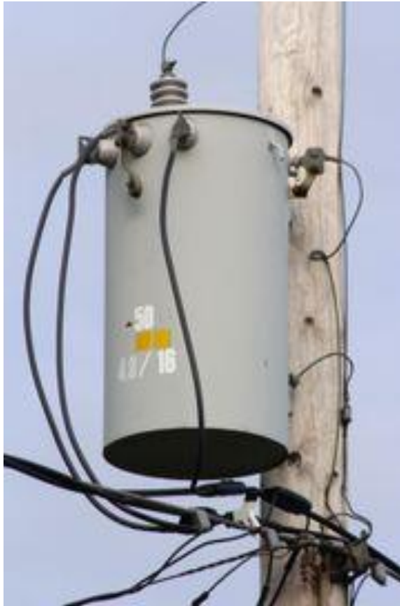
Transformador de distribuição monofásico
