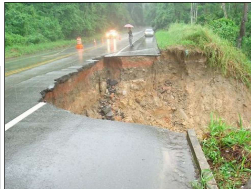
Figura 13: Deslizamento de terra arrasta pista da rodovia Rio-Santos na região de Angra dos Reis.
