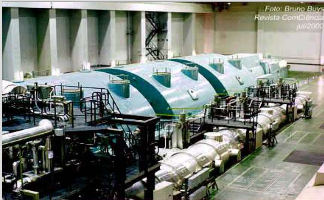
Vista interna da Usina Angra 2
