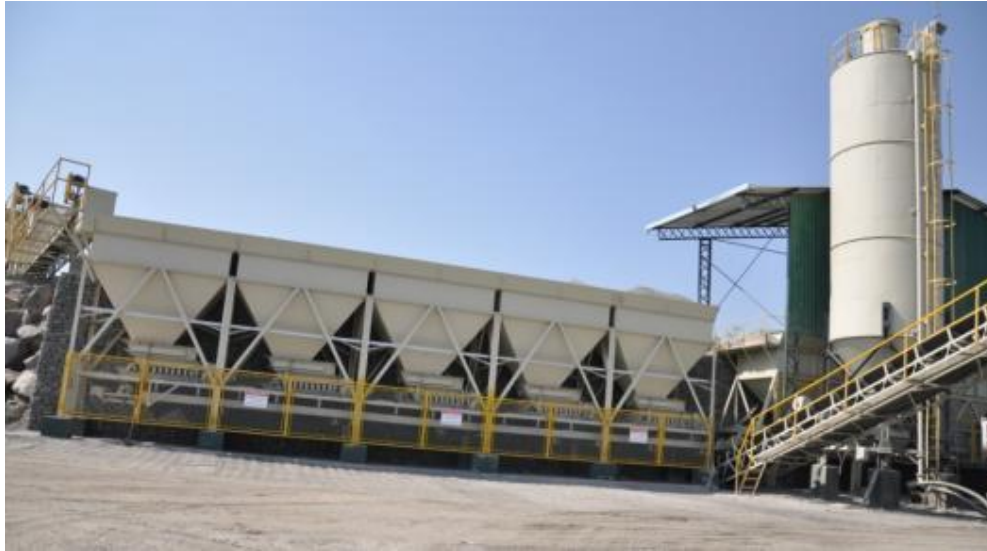
SISTEMA DE SILOS FRIOS
