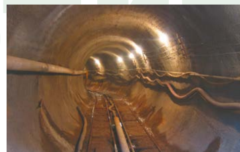
Figura 11 - Túnel para canalização de água com 3,00m de diâmetro.
