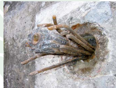
Figura 9 - Patologia - cabeças metálicas em processo de corrosão.
