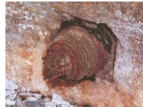
Figura 10 - Patologia - cabeças metálicas em processo de corrosão.
