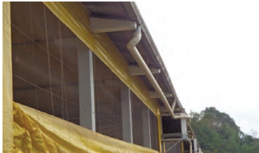
FOTO 01 | Sistema de captação da água da chuva instalado no telhado de uma granja de suínos.
