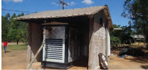
FOTO 21 | Motor gerando energia com biogás. Motor enclausurado e com abafador para reduzir a emissão de ruídos.
