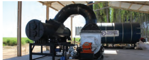
FOTO 28 | Sistema de geração de energia elétrica que utiliza turbina (em instalação), o biogás é queimado para gerar o vapor que movimenta a turbina. Capacidade de geração de 2500 kVA
