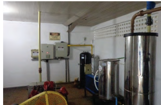
FOTO 22 | Conjunto de filtragem de gás sulfídrico do biogás, pré-gerador.
