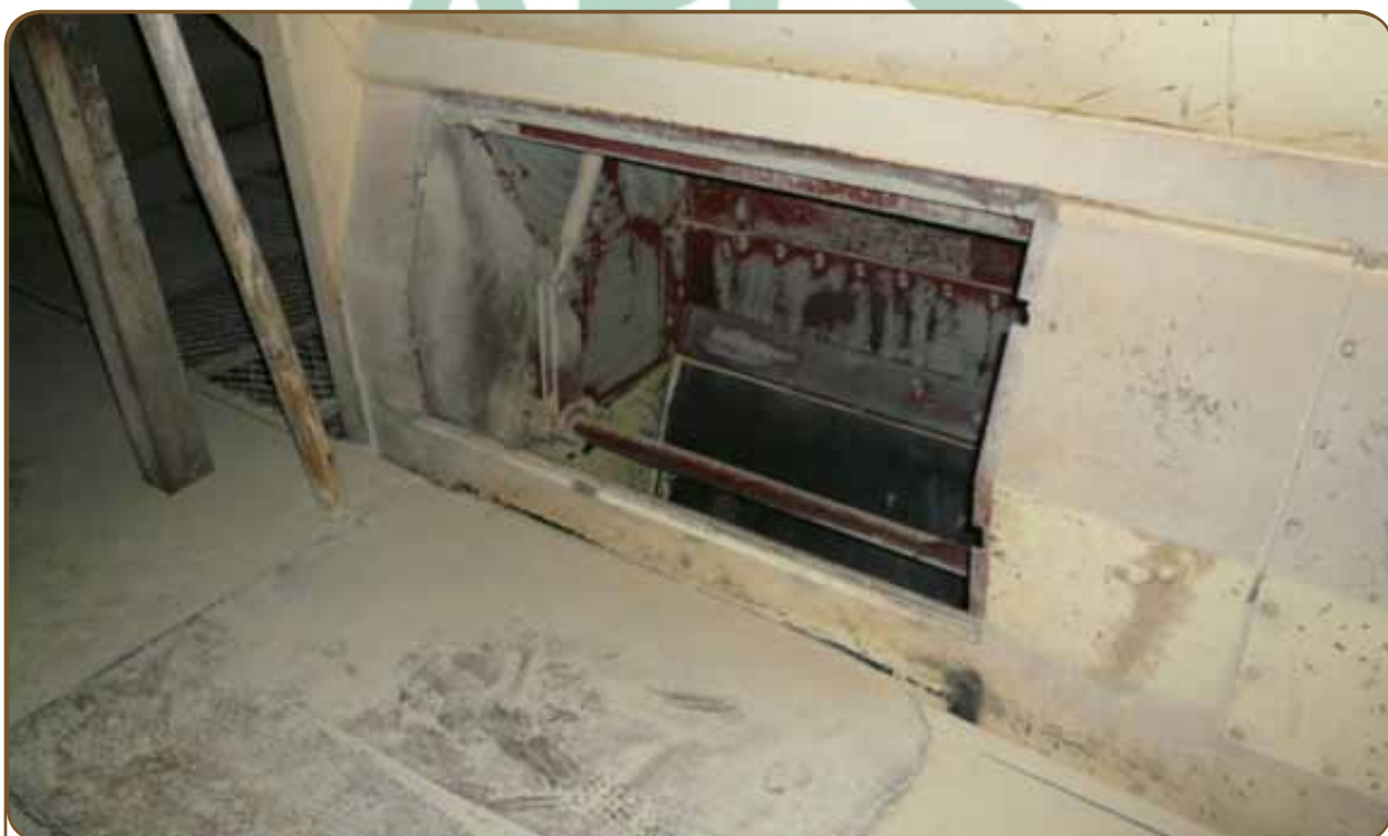
Figura 27: Abertura no misturador para realização de limpeza.
