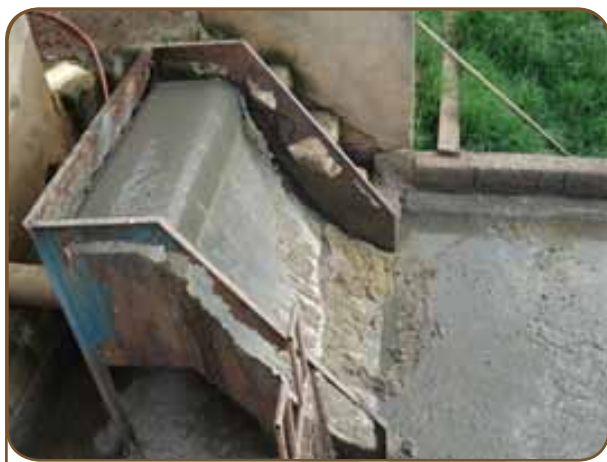
Figura 5: Separação prévia de sólidos para entrada no biodigestor.
