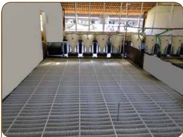
Figura 25: Instalação limpa e desinfetada com partes móveis montadas.
