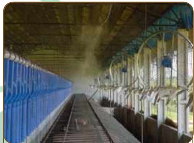
Figura 3: Ventiladores e nebulizadores.
