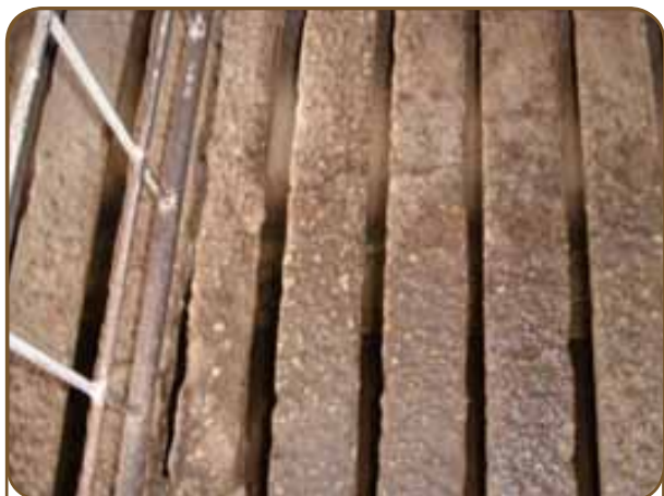
Figura 28: Piso de qualidade ruim nos ripados da gestação.
