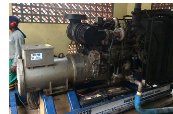
Foto 2. Gerador de energia elétrica movido a biogás
