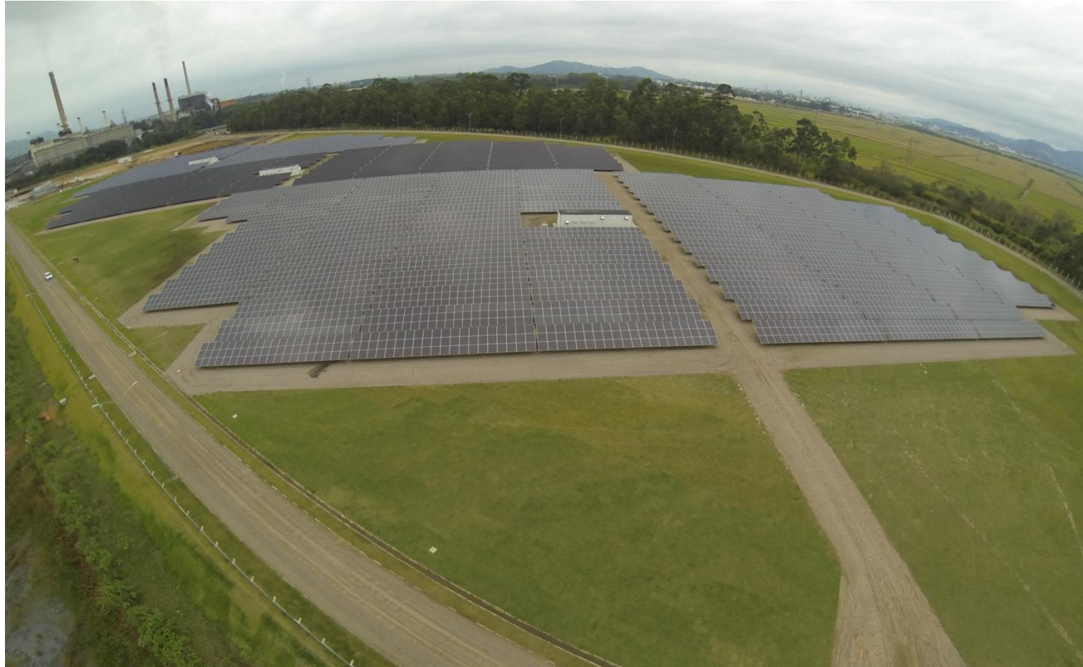
Usina de 3 MW, TRACTBEL , Tubarão, Santa Catarina (UFSC, 2014)
