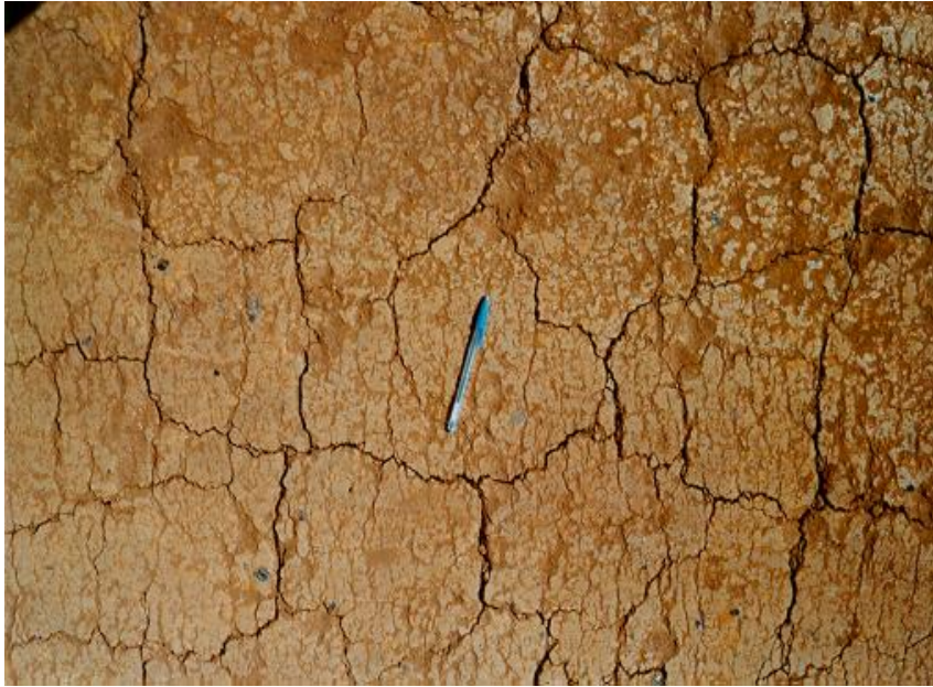
Argila laterítica compactada TRINCADA após perda de umidade
