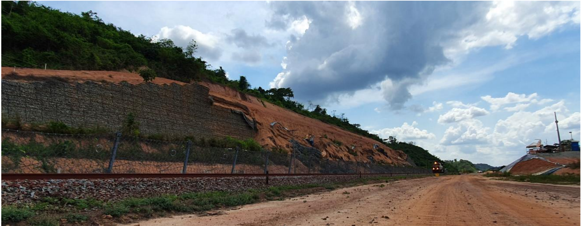
Figura 8 - km 408-409 - Área de ruptura do talude Foto: Robson Costa (Açailândia, PA)
