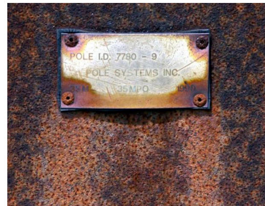
Corrosão galvânica dos parafusos de aço ao carbono pelo contato com chapa de latão
