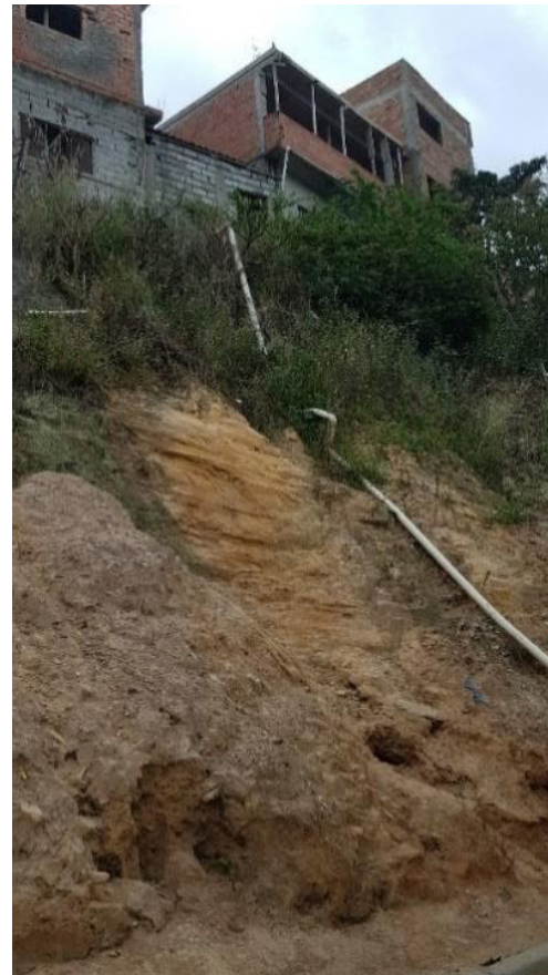
Fotografia 2 - Área de risco em Franco da Rocha
