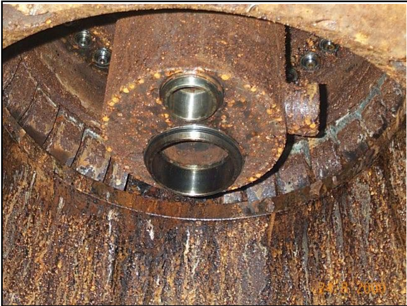
Corrosão localizada em componente de árvore de natal devido à corrosão galvânica
