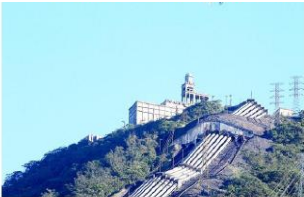
Tubulação da hidrelétrica de Henry Borden (Cubatão – SP)
