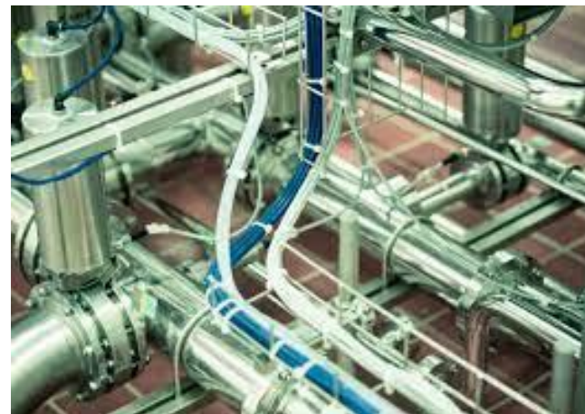
Tubulação de planta industrial
