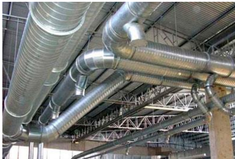
Sistema de dutos de ar condicionado
