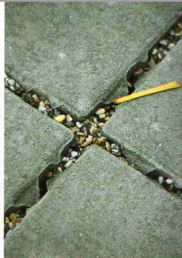
A água infiltra pelas juntas do piso
