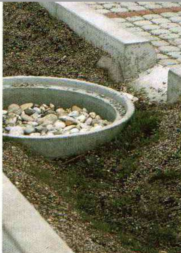
A água da chuva escoar para as valas pelas aberturas no meio-fio
