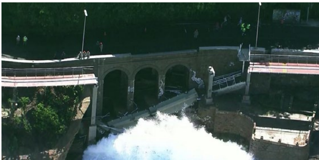
Figura 33: Foto publicada pelo G1, do trecho da ciclovia Tim Maia que desabou três meses após a sua inauguração. Nota-se a água do mar atingindo a base dos pilares. No momento do desabamento ocorria uma forte ressaca, com ondas muito mais fortes do que essa registrada pela foto
