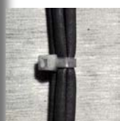
Cabo estrangulado (incorreto)
