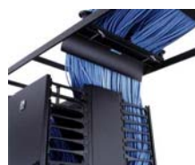
Cabos em Calhas Aéreas e Leitos (correto)
