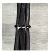
Cabo amassado (incorreto)
