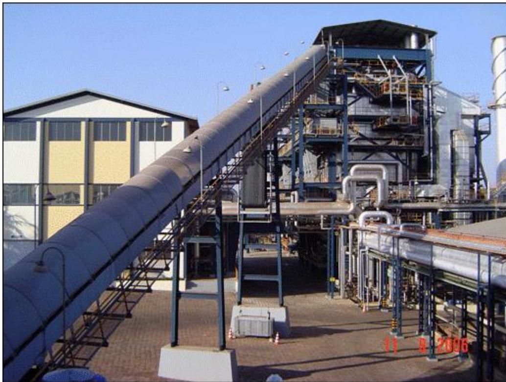
Caldeira (63 bar / 480°C) – Usina Santa Adélia
