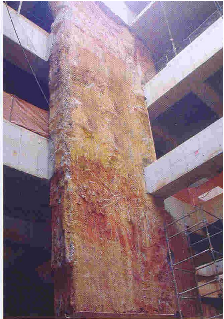
Estaca Barrete de 7,00 x 1,00 x 48,00 m de profundidade (funcionando também como pilar) - Metrô Linha 2 Estação Klabin - São Paulo / SP
