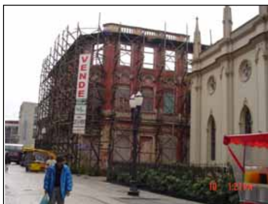
Figura 66: Casa Hauer - único imóvel cujo proprietário obteve a concessão de potencial construtivo e não realizou as devidas obras de restauração na unidade.
