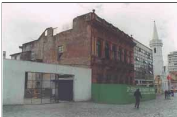
Figura 23: Casa deteriorada no Largo da Ordem.
