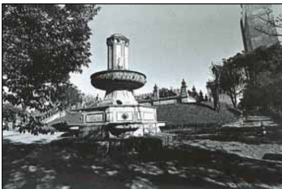
Figura 31: Reservatório Alto São Francisco antes da restauração Fonte: Acervo da Secretaria de Comunicação Social
