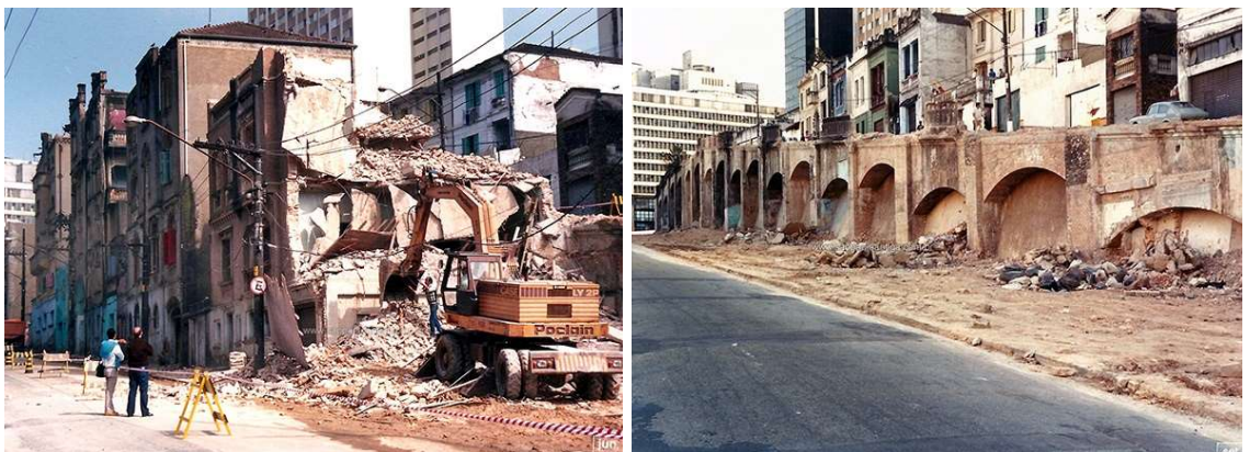
23. A demolição dos casarões. À esquerda, escavadeira derrubando edificações na Rua da Assembleia. À direita, os arcos sendo revelados em meio ao processo de destruição. Fotos: Ronald Kyrmse, 1987.
