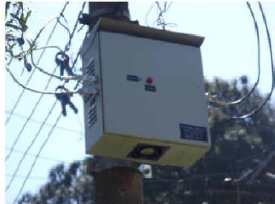
Figura a2 – Foto do RTPBT em Instalação no CT da AES Eletropaulo
