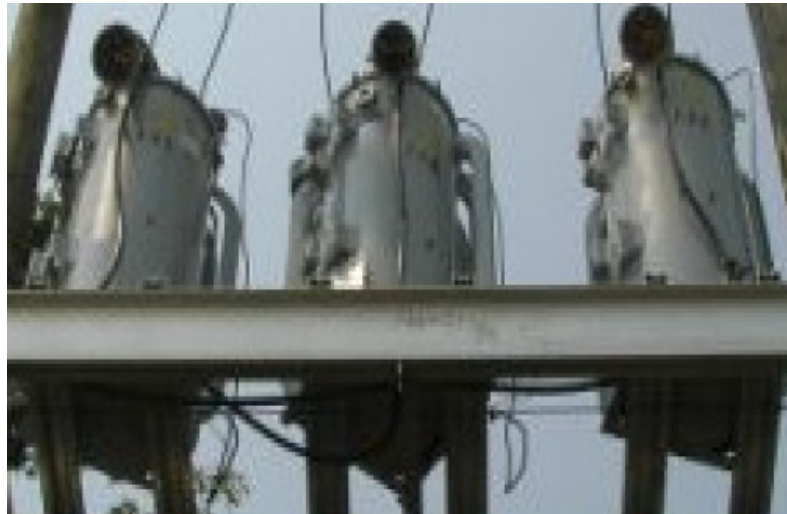
Regulador de Tensão Média Tensão
