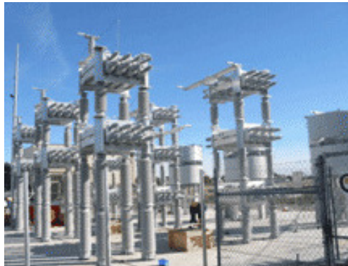
Banco de capacitores da subestação
