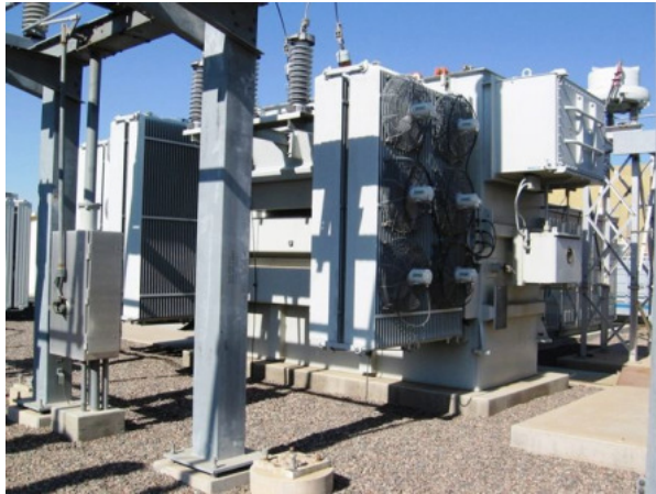
Transformador de grande porte instalado em uma Subestação
