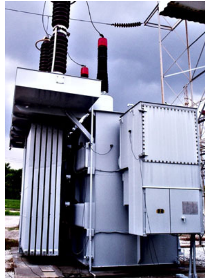
Transformador com controle de automático de TAPs na Subestação
