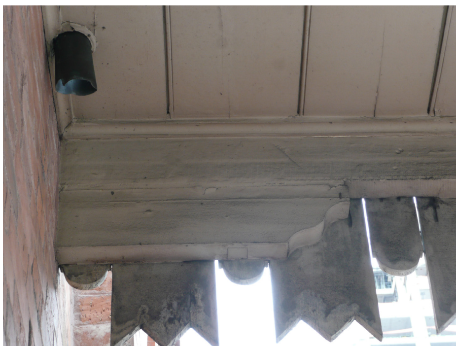
Ausência de descida de água pluvial
