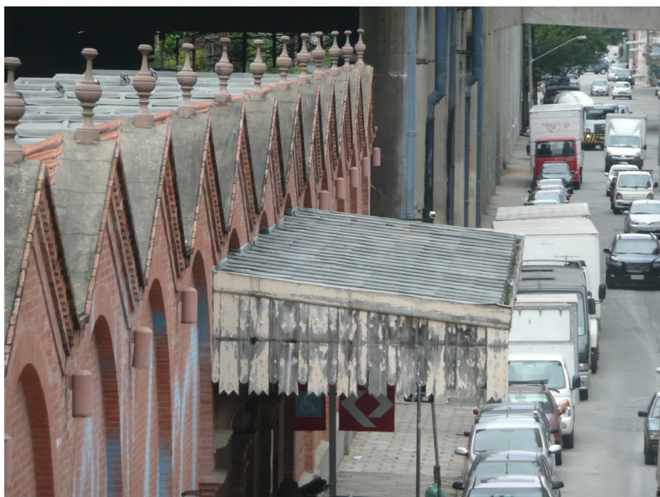
Vista da marquise do acesso principal a partir do viaduto Maestro Alberto Marino
