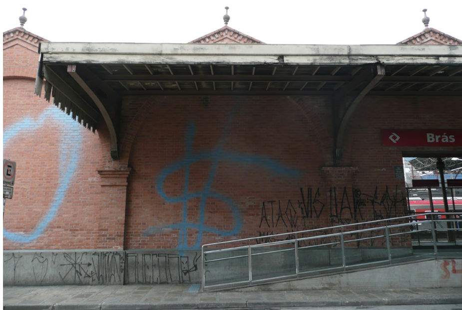
Ausência dos lambrequins na elevação frontal
