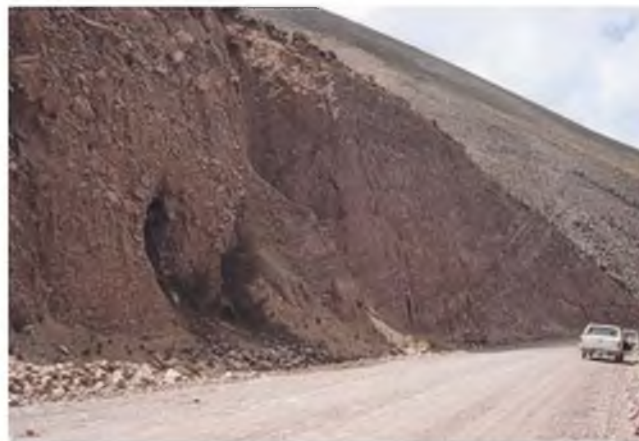
Figura 9.5 Talud excavado en suelos coluviales y roca muy alterada con inestabilidades controladas por la baja resistencia de los materiales y por la presencia de agua estacional circulando por el interior del terreno.
