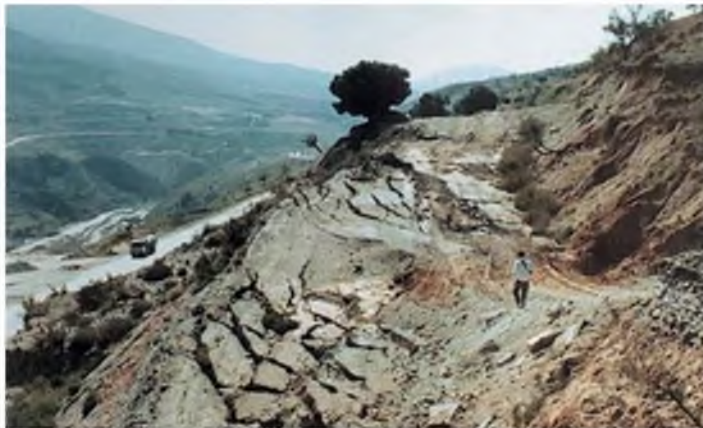
Fotografía E. Daños en autovías por deslizamientos (Granada)
