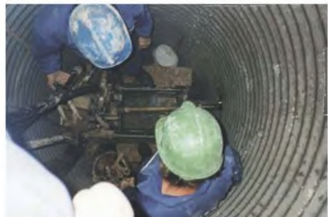
Figura 9.58 Perforación de drenes horizontales desde el interior de un pozo de drenaje para conectar con los pozos contiguos (cortesía de P. Berenguer).
