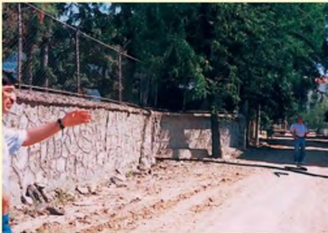
Figura A. Desplazamiento lateral de 445 cm producido por falla superficial (foto L. González de Vallejo).
