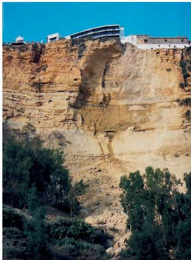
Figura 14.23 Desprendimiento de un gran bloque en un talud vertical calcarenítico motivado por pérdidas en la red de aguas de la población, Arcos de la Frontera, Cádiz (foto M. Ferrer).
