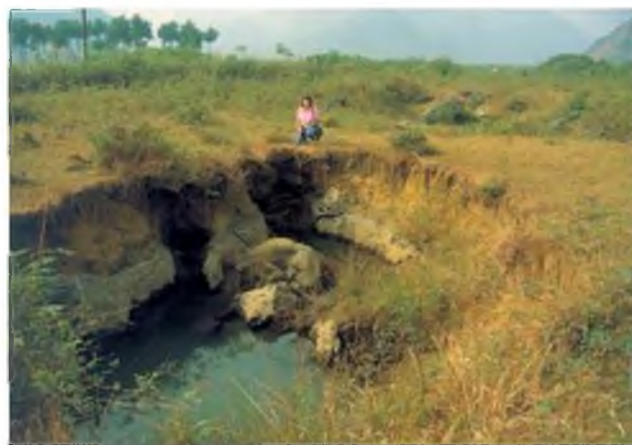
Figura 14.38 Hundimiento en materiales aluviales sobre calizas (cortesía de J. J. Durán).
