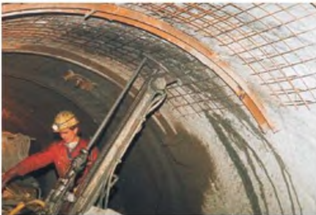
Figura 10.25 Instalación de bulones friccionales tipo «Swellex», con cerchas, mallazo y gunita (cortesía de M. Trimboli).
