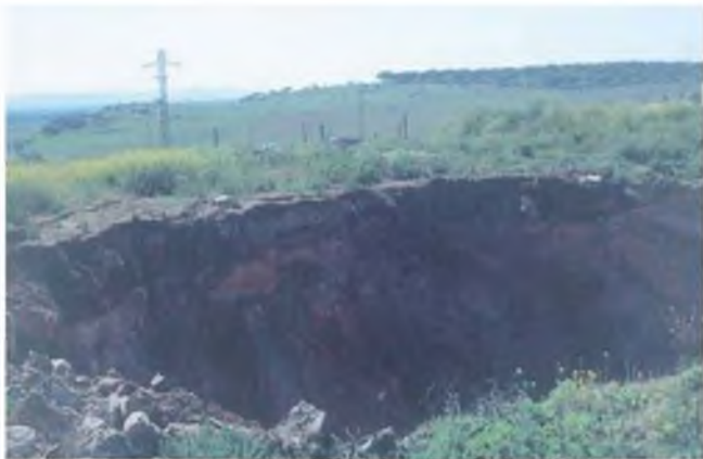
Figura 14.39 Socavón producido por el hundimiento de una antigua galería minera en la zona kárstica de El Calerizo, Cáceres (cortesía de J. J. Durán).
