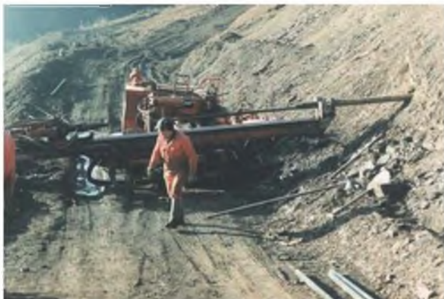
Figura 9.57 Realización de drenes horizontales en un talud (foto L. González de Vallejo).
