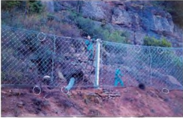
Figura 14.35 Barrera dinámica para contención de desprendimientos, Montserrat, Barcelona (foto L. González de Vallejo).
