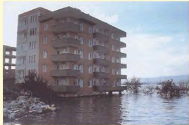
Figura C. Subsistencia tectónica producida por fallas normales durante el terremoto de Kocaeli, con inundación de la primera planta del edificio (Yilmazer, 2000).
