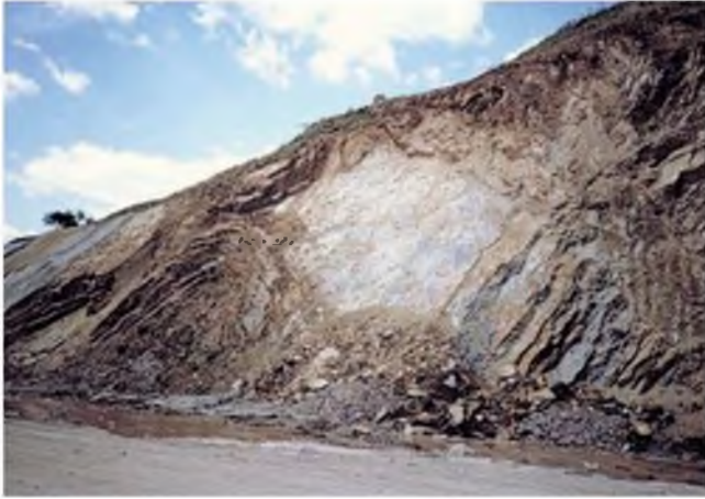
Figura 9.6 Talud excavado en rocas lutíticas fracturadas y plegadas con roturas controladas por la estructura del macizo rocoso, Brazatortas, Ciudad Real (foto M. Ferrer).
