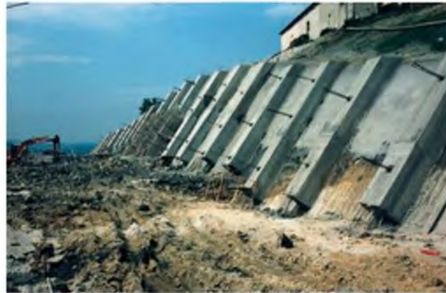
Figura 9.64 Instalación de anclajes para reforzar el talud, unidos mediante vigas de hormigón armado para que trabajen de forma solidaria, Asturias (foto L. González de Vallejo).
