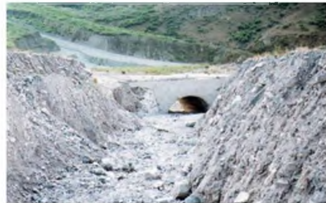
Fotografía D. Colmatación de cauce que rebasa la carretera y obliga a abrir un cauce artificial, Quebrada de Purmamarca, Argentina (foto M. Ferrer)
