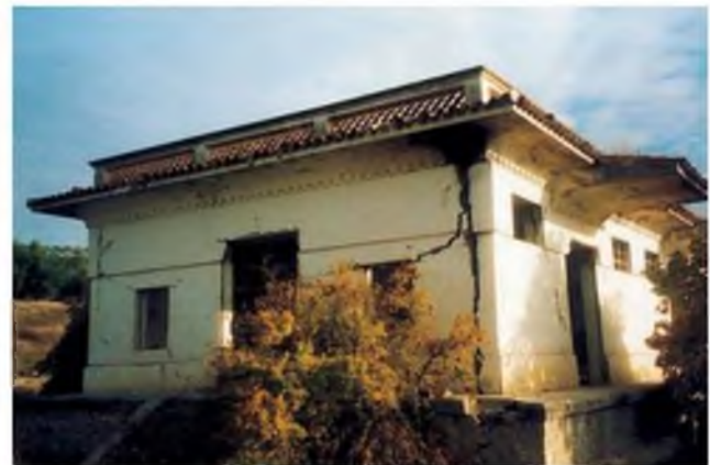
Figura 2.93 Estación agrietada por la expansión de arcillas, Jaén (foto C. Oteo).
