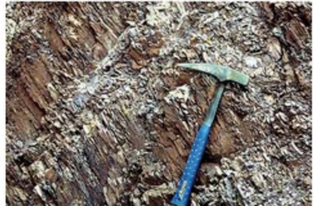
Pizarras paleozoicas. Calidad muy mala. Fracturación muy intensa. Grado de meteorización V.
