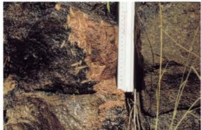
Figura 4.16 Circulación de agua a favor de discontinuidades en un macizo rocoso muy meteorizado de areniscas (cortesía de Prospección y Geotecnia).
