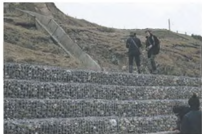
Figura 9.67 Muro de gaviones a pie de talud y cuneta de drenaje (foto L. González de Vallejo).
