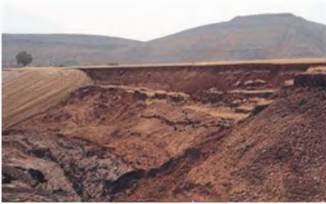
Figura 9.12 Rotura curva de un talud en suelos arcillosos y pizarras, Puertollano, Ciudad Real; se observa la grieta de tracción y el salto vertical de la cabecera del talud (foto L. González de Vallejo).
