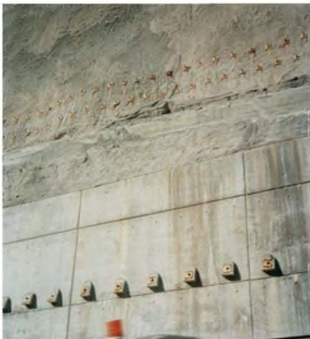
Figura 9.69 Medidas de estabilización en talud de carretera: muro anclado en la parte inferior, gunita y bulones en la parte superior (foto M. Ferrer).
