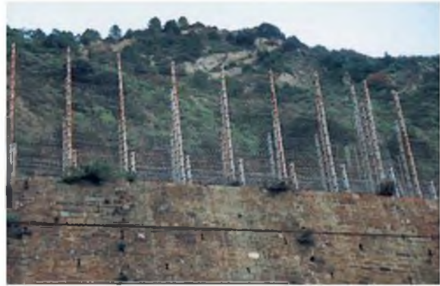
Figura 14.34 Barreras estáticas formadas por postes y mallas para protección frente a deslizamientos; Liguria, Italia (foto L. González de Vallejo).
