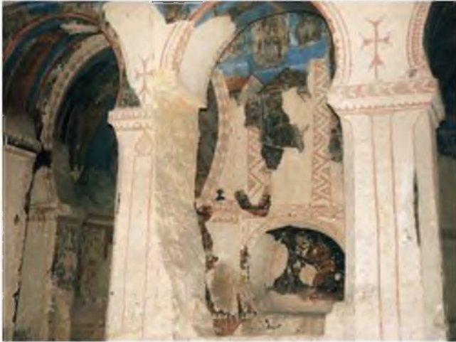
Figura 3.37 Rotura a compresión de un pilar en una iglesia paleocristiana excavada en tobas volcánicas, Capadocia, Turquía (foto M. Ferrer).
