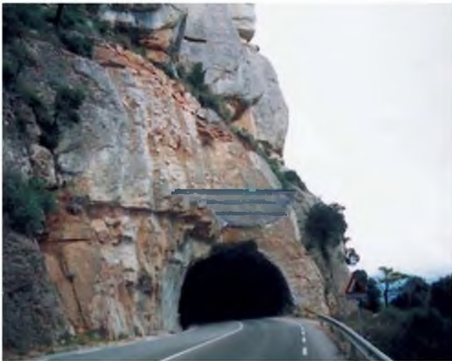
Figura 14.36 Galería dinámica horizontal en la salida de un túnel para contención de desprendimientos, Montserrat, Barcelona (cortesía de Prospección y Geotecnia, S. L.).
