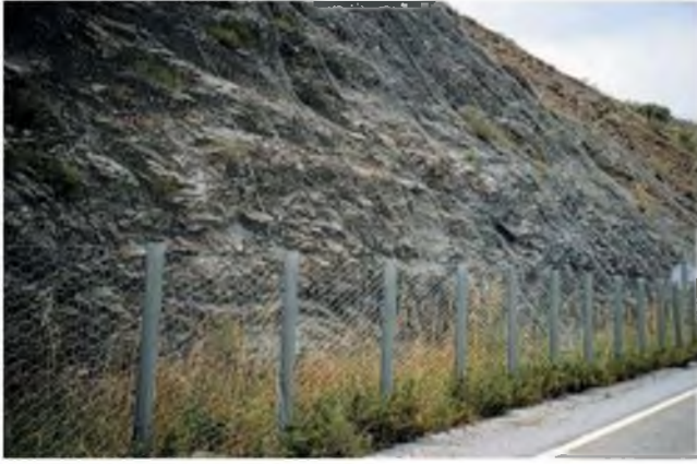
Figura 9.71 Protección superficial de taludes con mallas metálicas. A pie de talud se ha instalado una barrera para evitar la caída de rocas a la carretera (foto M. Ferrer).
