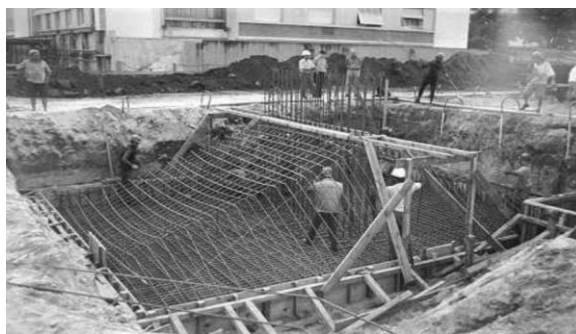
Construção de uma sapata de 7x 9m, executada para fundação de um edifício.
