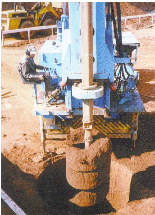
Figura 7.1 - Fustes de tubulões escavados a céu aberto com Ø 60cm a Ø 120 cm (BASE Fundações e Infra-Estruturas Ltda.)
